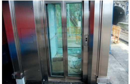
Portugaletre: igogailua instalatu berri dute. Bisita egin zenean ez zegoen martxan. Gauza bera Zorrotzan
