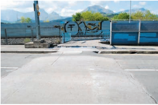
Traña: industria ingurunea. Ibilgailu astunen trafikoa. Zoladura eskaseko espaloi estuak
