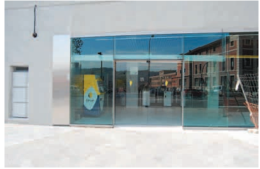
Basurto: sin banda horizontal de señalización de marcado contraste visual
