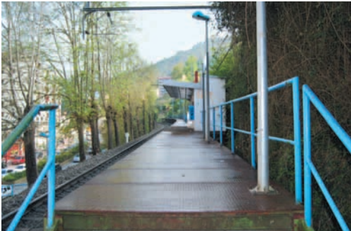
Andén peligroso. Suelo resbaladizo
