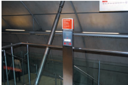
Sistema de comunicación por interfono
