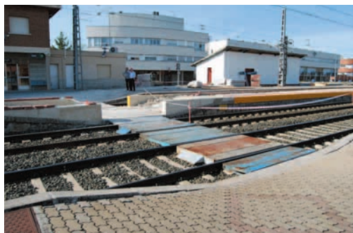
Salvatierra-Agurain: paso de superficie entre andenes. Pavimento en mal estado
