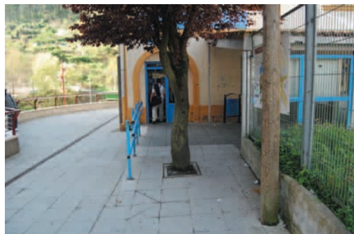
Ermua: rampa de acceso al andén y al vestíbulo de la estación obstaculizada por la presencia de un árbol. Estrechez de paso
