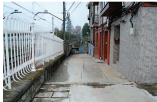
La Iberia: acceso peatonal en pendiente con pavimento en deficiente estado
