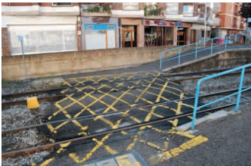
Paso a nivel en estado de conservación deficiente
