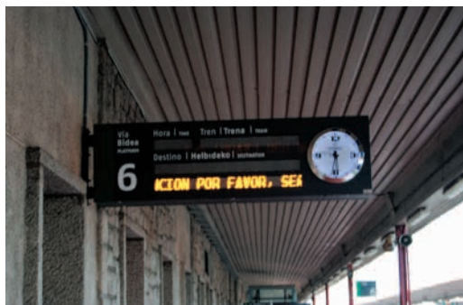
Teleindicadores en estación de Irún
