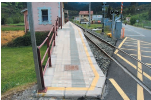
Ibarra: el acceso al apeadero no está rebajado. Itinerario junto a paso a nivel. Peligroso
