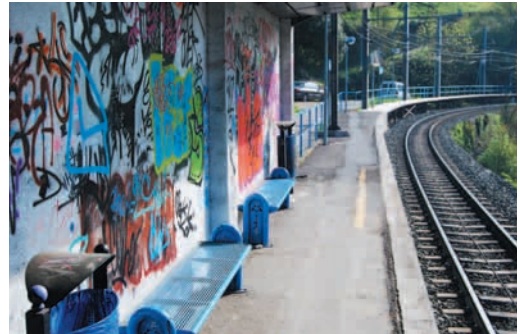
Pavimento desgastado. Estado deficiente
