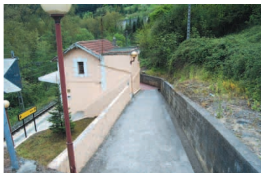
La Herrera: rampa de pendiente pronunciada. Acceso impracticable contiguo a una zona de tráfico intenso
