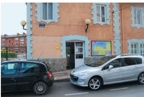
Zalla: puerta estrecha. No hay operatividad de desplazamiento para una silla de ruedas salvo que ambas hojas estén abiertas
