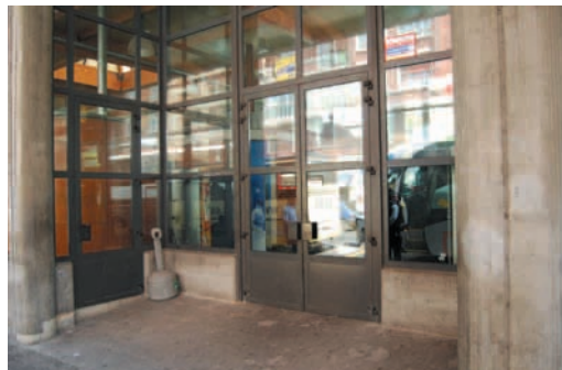
Puertas cerradas en el acceso desde la rampa. Necesaria asistencia de un tercero
