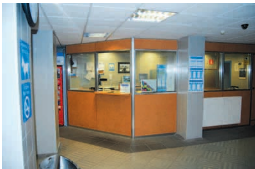
Bermeo: mostrador no atendido y sin acondicionar (no hay tramo a menor altura ni hueco de profundidad adecuada)
