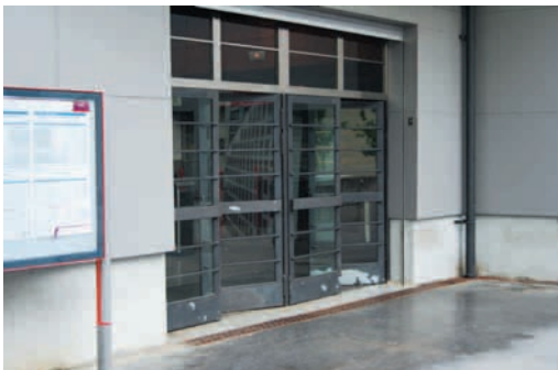
La Peña: puertas convencionales de acceso al edificio. Estrechas y pesadas
