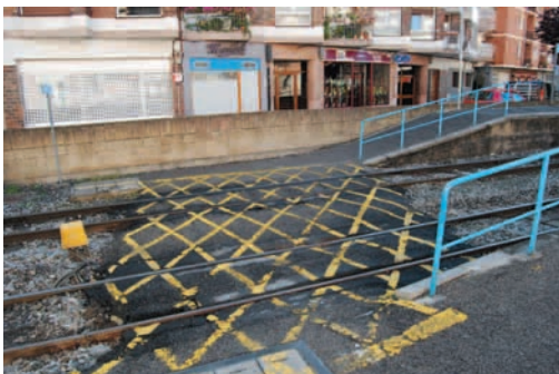
Berriz: paso a nivel en estado deficiente en el recorrido peatonal hacia la estación
