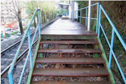
Errotabari Ermua: tramo de escaleras sin tabicar para acceder al andén. Suelo resbaladizo y peligroso
