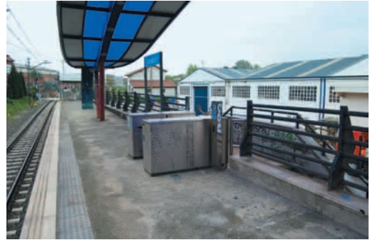
Elotxelerrri: pavimento muy deteriorado en determinadas zonas
