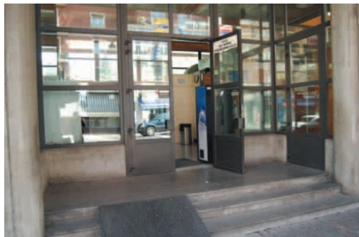
Rampa no acondicionada. Pendiente excesiva. Puerta estrecha
