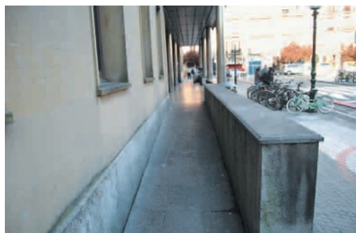
Donostia-Amara: rampa de acceso no acondicionada. No dispone de pasamanos en ambos lados, a doble altura, y a lo largo de todo el recorrido
