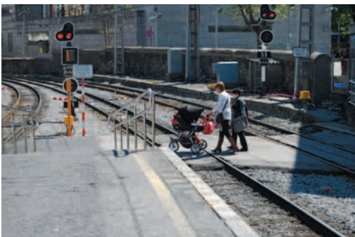
Durango: acceso al andén a través de un paso a nivel de pavimento deficiente y con una rampa de pendiente pronunciada
