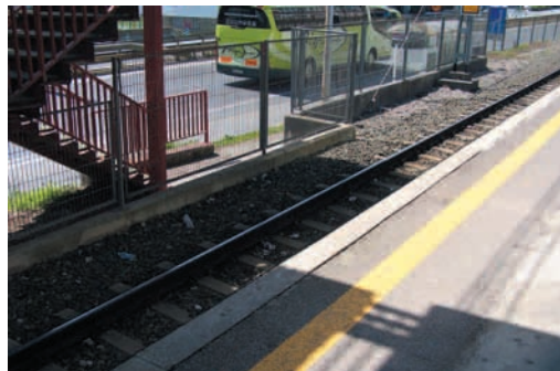
Rekalde: andén sin pavimento táctil de seguridad
