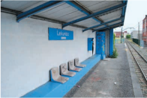
Lekunbiz-Zamudio: pavimento deteriorado sin señalización de seguridad
