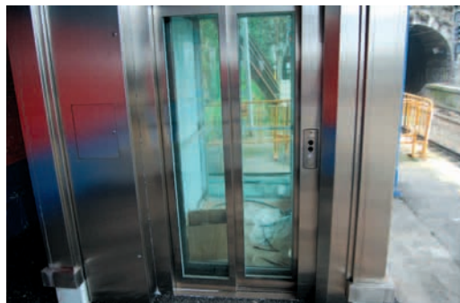
Portugalete: reciente instalación del ascensor. En estado no operativo cuando se realizó la visita. Ídem en Zorrotza
