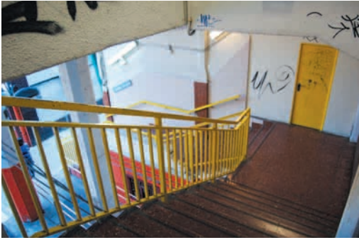
Irun Colón: acceso al andén a través de tramos de escaleras no acondicionadas. No hay ascensores
