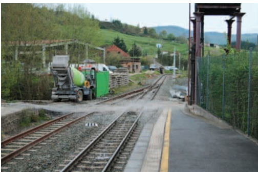
Villaverde de Trucios: acceso lateral con entorno en obras. Paso a nivel en estado deficiente
