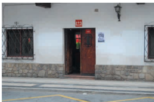
Ordizia: escalón de acceso al vestíbulo de la estación. Puerta estrecha
