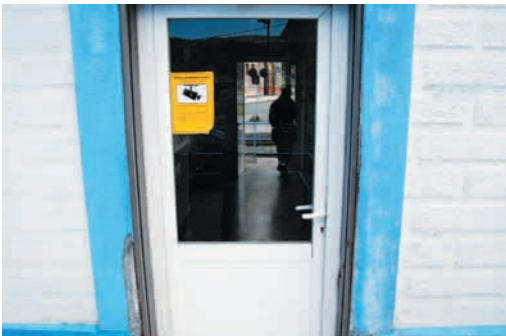
Zuhatzu-Galdakao: puerta de acceso al vestíbulo cerrada y estrecha
