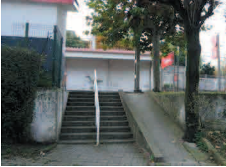
Ategorrieta: rampa de acceso al andén no acondicionada. Pendiente pronunciada. Impracticable
