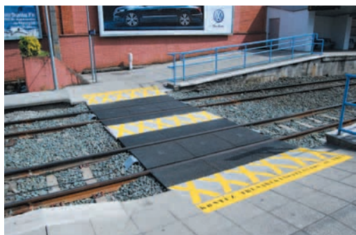
Gernika: paso a nivel de metal caucho en buen estado de conservación y con señalización adecuada
