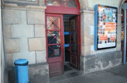
Durango: disposición de puertas convencionales antes que las puertas automáticas. Imprescindible que ambas hojas estén abiertas
