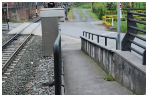
Eloitxerri: rampa de acceso al andén con pendiente pronunciada y peralte. Sin pasamanos de asistencia
