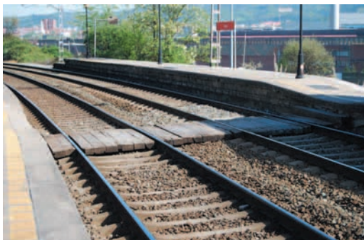
Basauri: estación en curva (baja visibilidad). Paso a nivel altamente peligroso. Hay escalón para bajar a la vía
