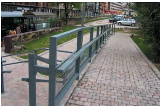
Pasajes: construcción de una rampa de acceso al andén desde la calle
