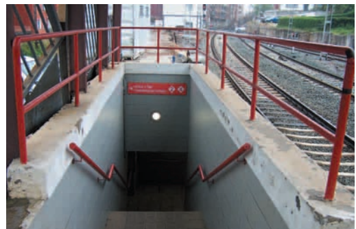
Valle de Trápaga: paso subterráneo con escaleras no acondicionadas para acceder a las vías. Sin señalización de seguridad
