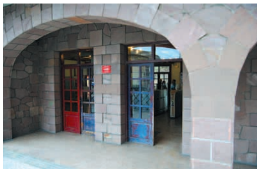
Lezo-Rentería: puertas exteriores de anchura no adecuada
