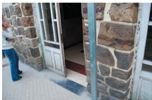
Zumarraga: puertas estrechas y poco funcionales. Ambas hojas deben estar abiertas
