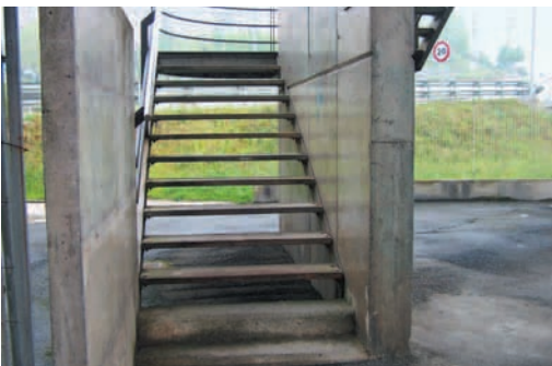
Galindo: tramos de escaleras no acondicionadas para acceder al andén (sin tabica). Peligroso. Nula señalización de seguridad
