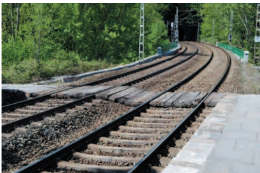
Bakiola: paso entablonado con recorrido abombado que dificulta el tránsito sobre las vías
