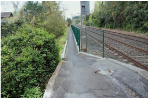
Hernani centro: pavimento en condiciones deficientes. Rampa no acondicionada sin protección lateral
