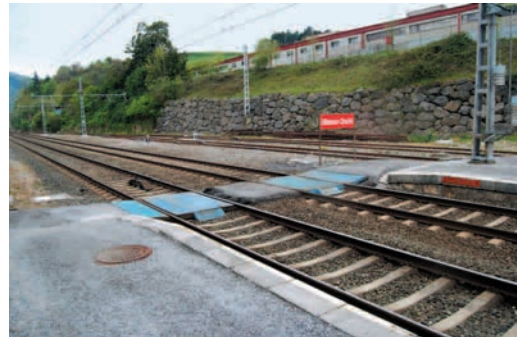
Billabona-Zizurkil: pavimento muy deficiente en zonas próximas al paso a nivel
