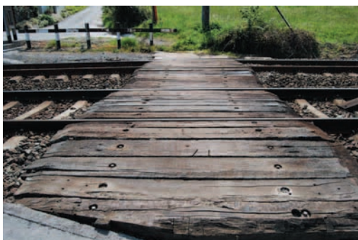
Paso a nivel entablonado. Pavimento abombado con resaltes e irregularidades
