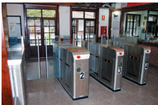
Dispositivos de cancelación con paso para personas con movilidad reducida de anchura adecuada
