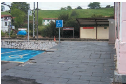
Putxeta: rampa no acondicionada y defectuosa para el acceso al andén. Pavimento resbaladizo
