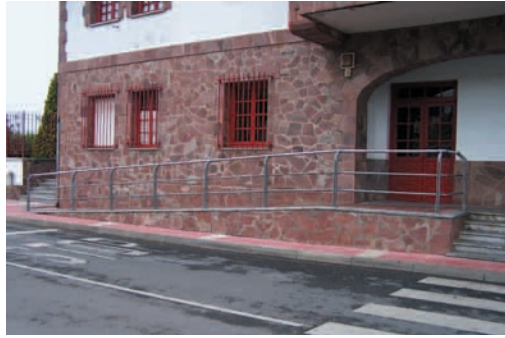
Muskiz: rampa de acceso no acondicionada. La barandilla tiene una función protectora, no de asistencia. Carencia de pasamanos en ambos lados y a doble altura. Puertas estrechas –una sola hoja abierta–
