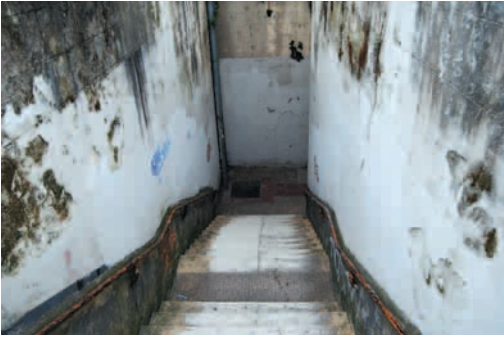
Herrera: el tránsito entre andenes se realiza a través de un paso subterráneo con escaleras, que no dispone de un pasamanos de asistencia al desplazamiento
