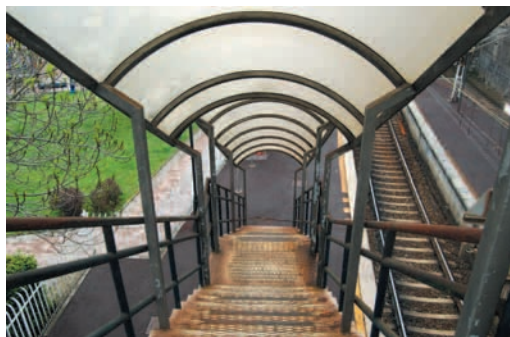
Peñota: paso elevado con escaleras. No está debidamente acondicionado. Pavimento peligroso en especial cuando está mojado
