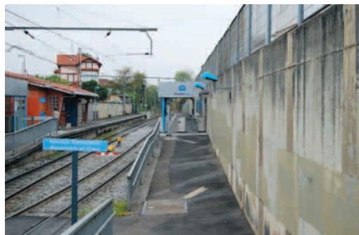
Larrondo-Loiu: rampa no acondicionada de acceso al andén. Pendiente y peralte excesivo
