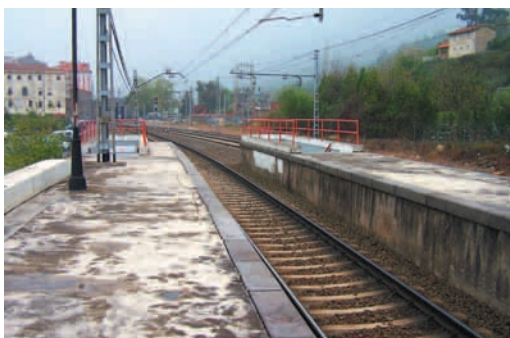
Ortuella: pavimento con grietas, irregularidades. Sin señalización de seguridad
