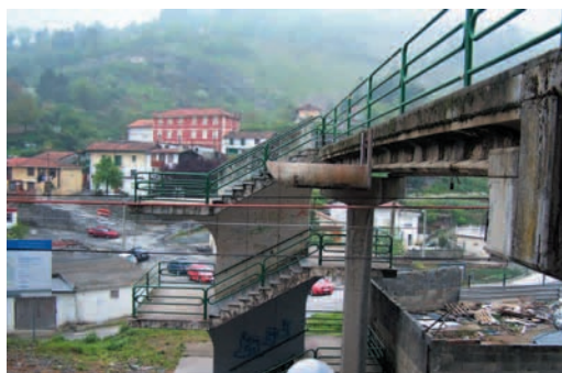
Sagrada Familia: tramos de escaleras no acondicionadas para acceder a las vías. Nula señalización de seguridad
