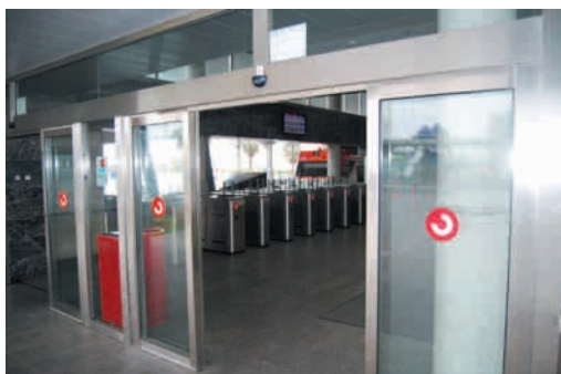
Santurtzi: puerta automatizada sin bandas horizontales de señalización
