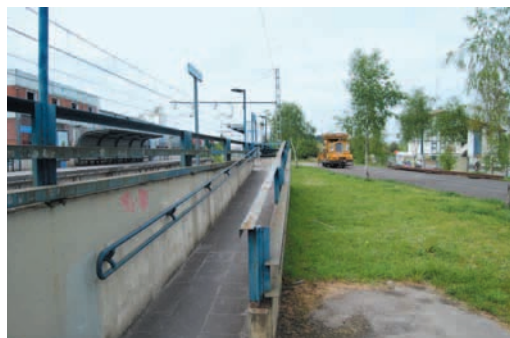
Kurtzea-Lezama: rampa no acondicionada de acceso al andén. La rampa concluye en una zona de escasa maniobrabilidad y con un poste en el recorrido final como obstáculo que limita la maniobrabilidad
