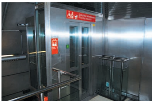
Ascensor que comunica el vestíbulo con el andén
