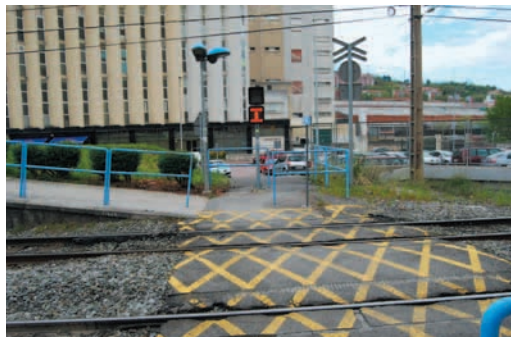
Ariz Basauri: pavimento en mal estado. Rampas no acondicionadas de acceso al andén
