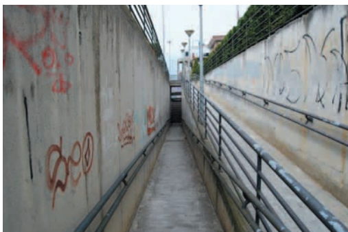
Derio: paso inferior con rampa de pendiente muy pronunciada. Escasa iluminación
