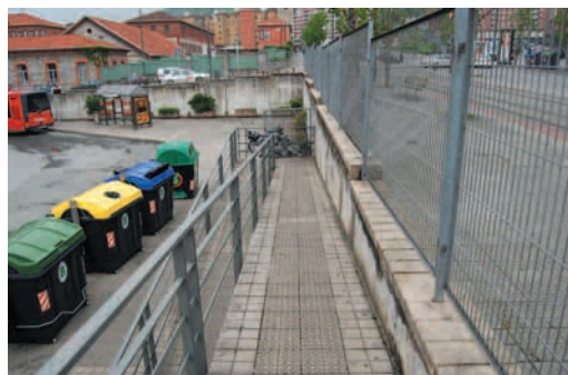
Acceso desde la zona de EITB. Rampa no acondicionada de pendiente pronunciada. No hay zona de descanso
