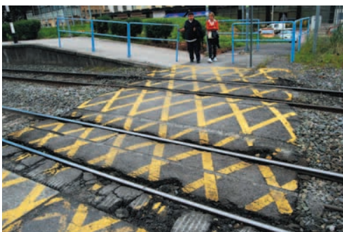
Ariz-Basauri: paso a nivel muy deteriorado y peligroso. Amplias zonas con desnivel debido a las irregularidades
