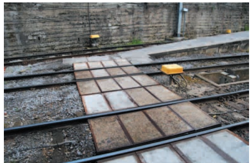
Paso a nivel con resaltes que no facilitan el desplazamiento
