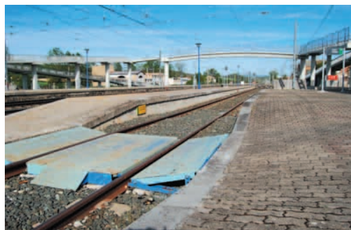
Alegria-Dulantzi: paso a nivel en deficiente estado con resalte y peralte peligrosos
