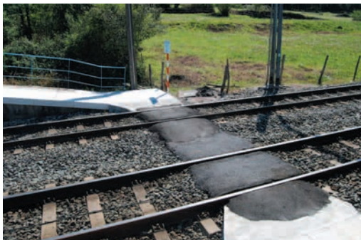
Bedia: rampas no acondicionadas y pavimento del paso a nivel en estado deficiente
