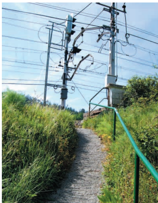
Bakiola: senda de acceso al apeadero. Impracticable. El otro acceso se materializa a través de escaleras sin acondicionar
