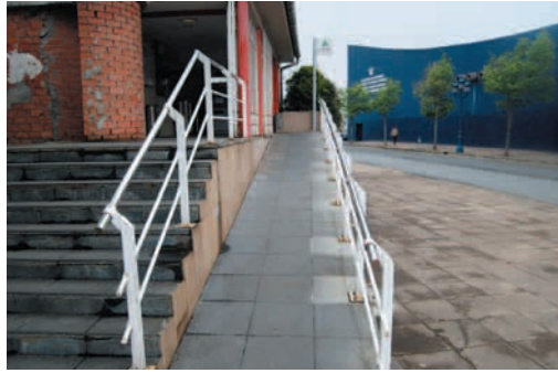
Peñota: rampa de acceso no acondicionada. Carencia de pasamanos en ambos lados
