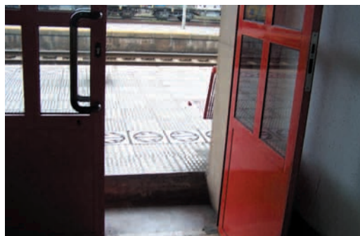
Pasajes: puertas exteriores e interiores estrechas y de doble hoja. Escalón de acceso al andén
