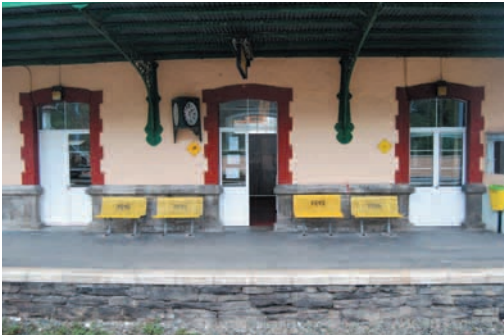
Carranza: puerta estrecha de acceso al edificio. Andén sin señalización de seguridad
